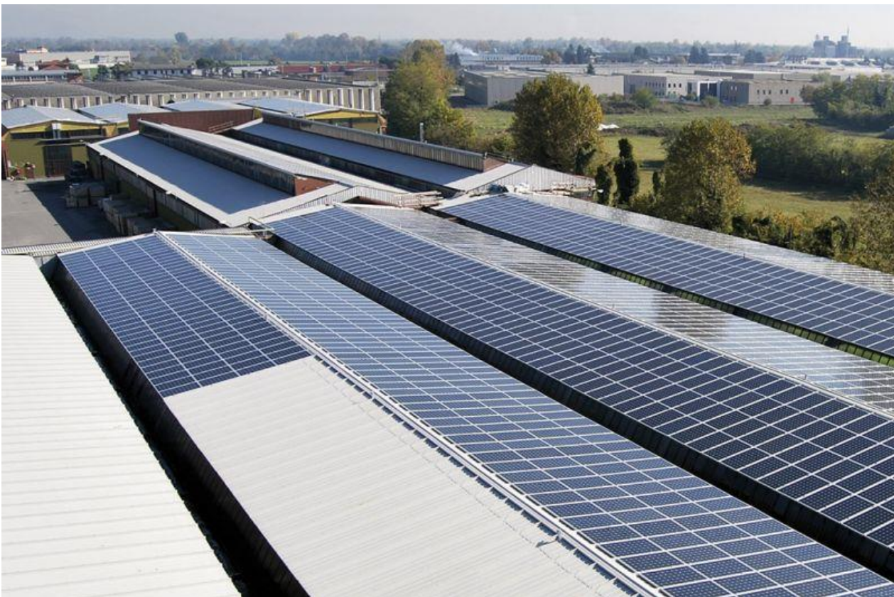
(Esempio di sistema fotovoltaico industriale sul tetto di un'azienda)
