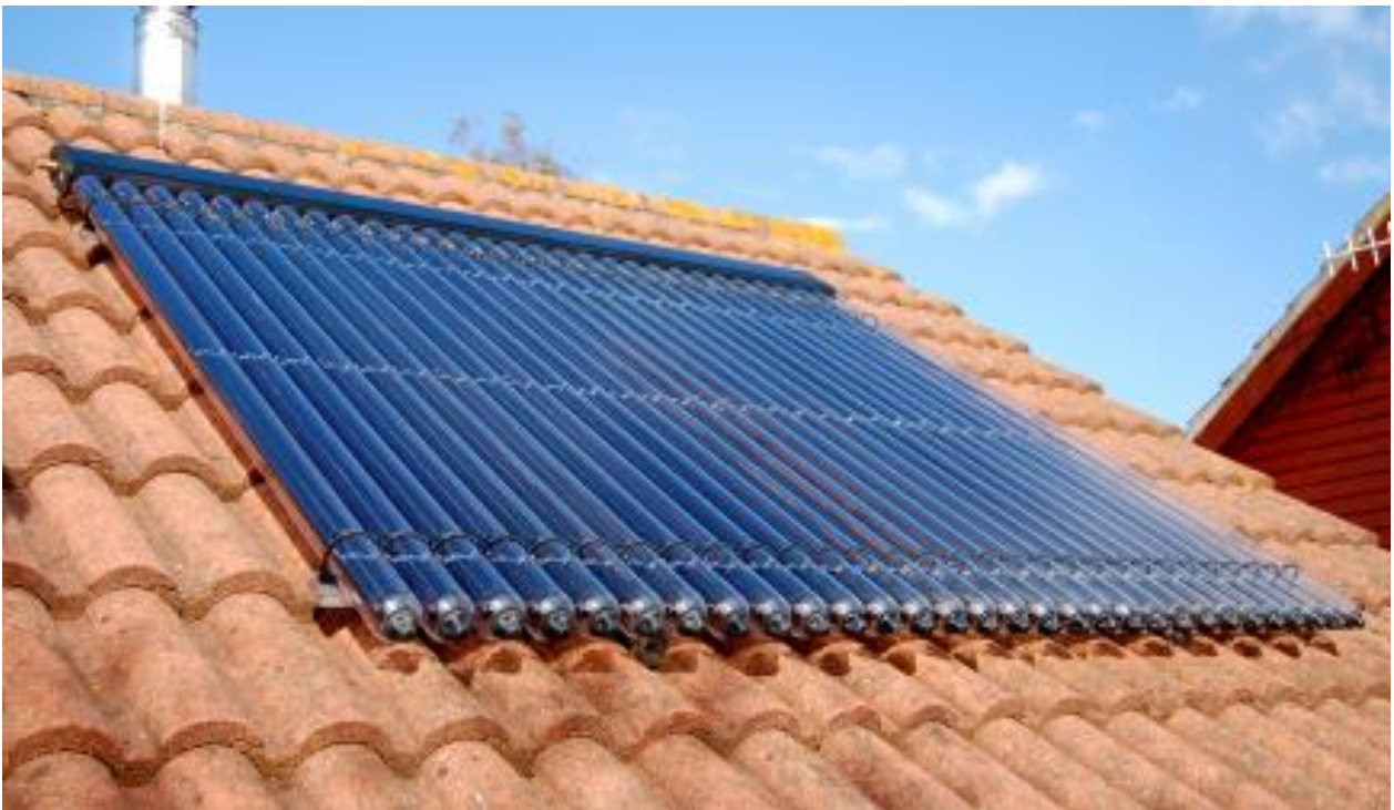
(Esempio di installazione di pannelli termici sottovuoto: la caratteristica principale è il tubo di vetro)
