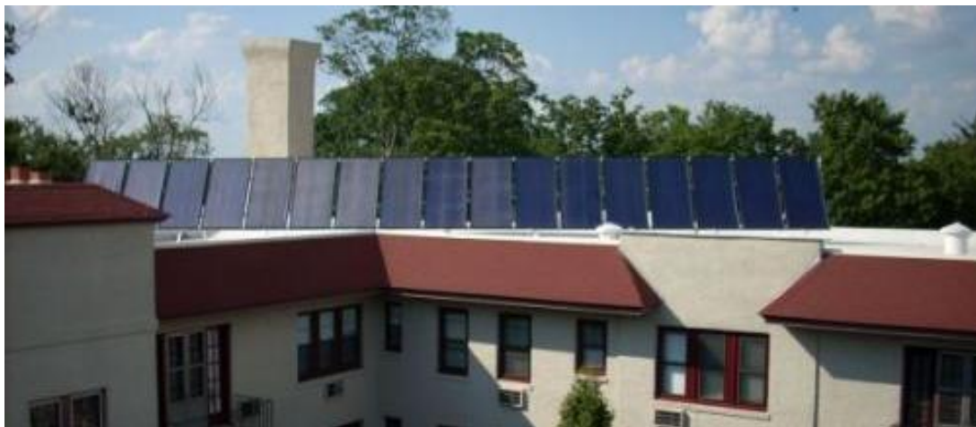
(Esempio di impianto fotovoltaico sul tetto di un condominio)
